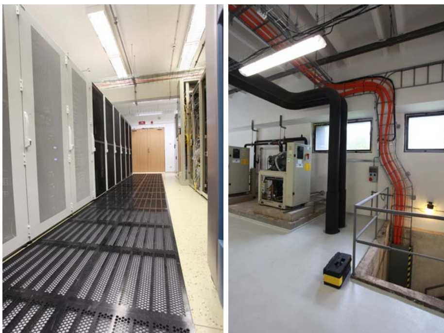
Obrázek 4: Serverovna UI420 a výměňková stanice.
